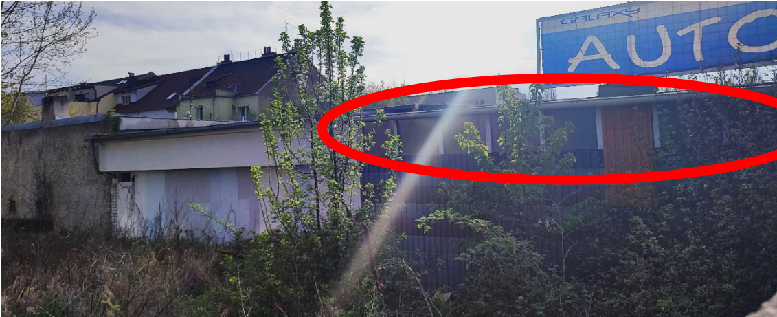
Obrázek č. 7: Objekt č. p. 1169, který je součástí pozemku parc. č. 798/4 v k. ú. Lobzy v ul. Rokycanská, okenní otvory
